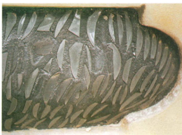
Ryc. 6. Kłasztor w Kamieńcu Ząbkowickim. Fasada. Fragment płyciny pod oknem pierwszego piętra
