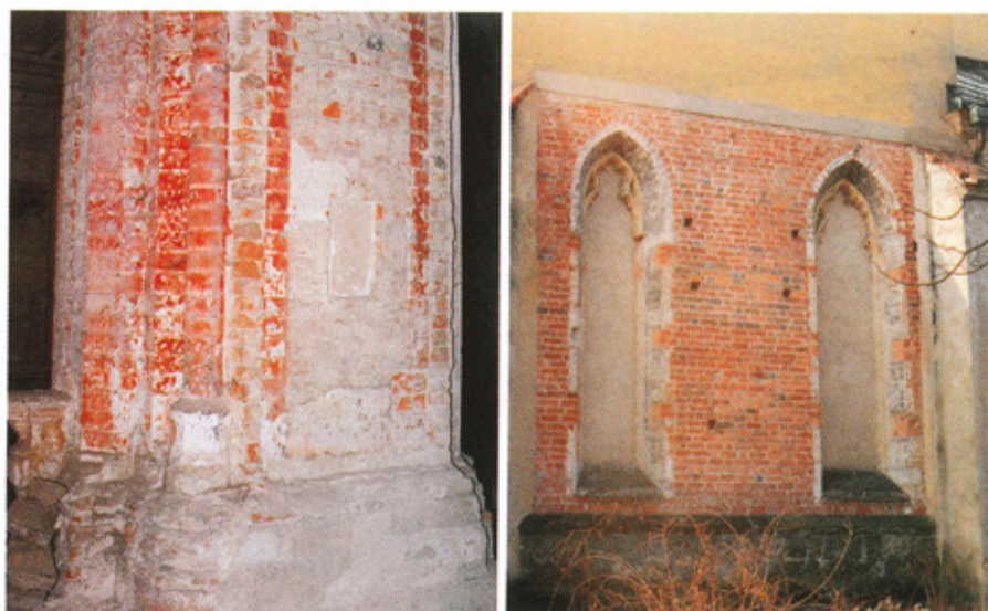
Ryc. 4. Lubiąż. Kościół klasztorny – fragment filara nawy po odpadnięciu tynków. Z prawej – resztki na biało malowanych ościeży okiennych na zewnętrznej elewacji chóru (fot. autora)
