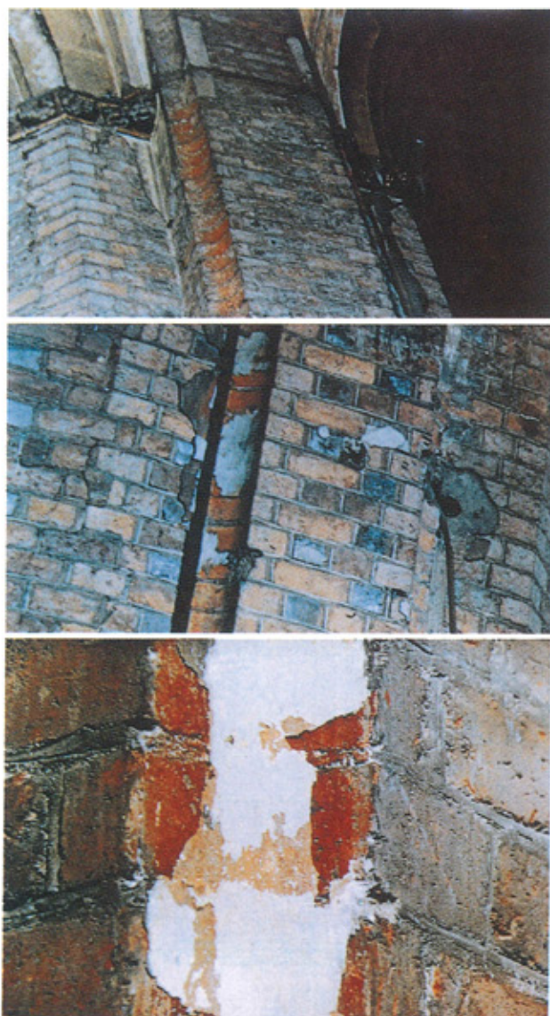
Ryc. 2. Wrocław. Kościół św. Wincentego – fragmenty zachowanej faktury i kolorystyki ceglano-wątku ścian i filarów z pomalowaniem wklęsłych krawędzi. Stan z 1962 r. (fot. autora)
