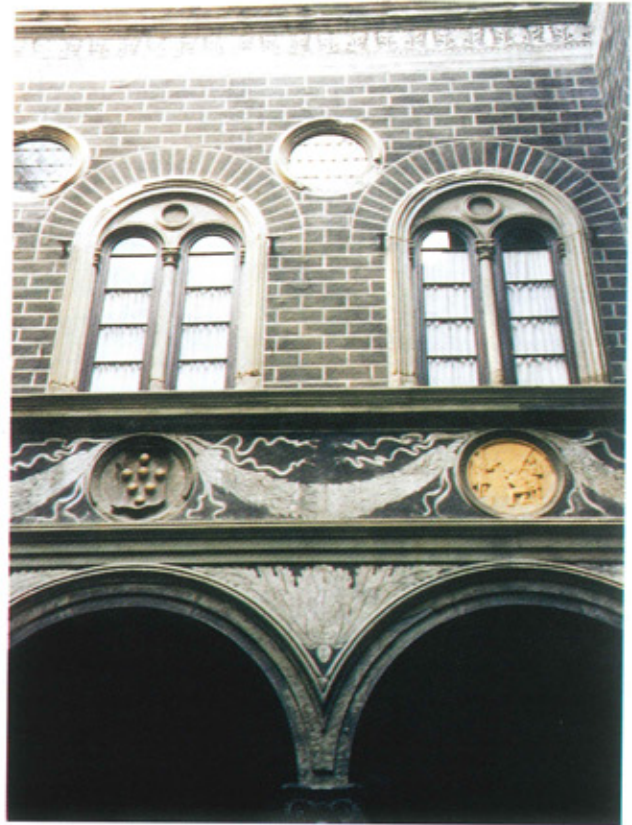
Ryc. 1. Bonie sgraffitowe typowe dla architektury włoskiej, Florencja, Palazzo Medici-Riccardi, od strony dziedzińca
